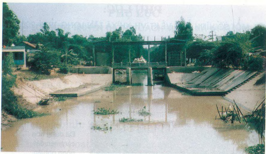
Cống đập thủy lợi rạch Mã Trường (ấp Tân Hội - Tân Long).
