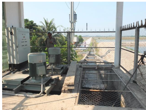
Hoạt động của Trạm bơm điện tại Hợp tác xã dịch vụ nông nghiệp Mỹ Đông 2 được điều khiển từ xa thông qua điện thoại thông minh
